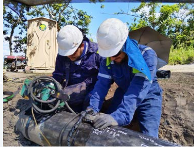
MAPEO DE CORROSIÓN
